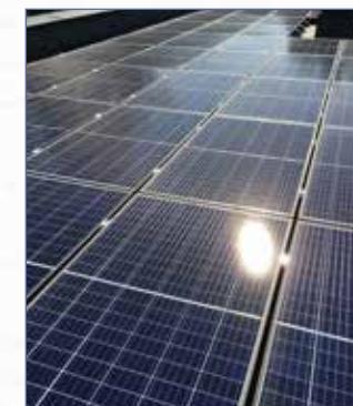
La consommation électrique du bâtiment est couverte par la production grâce aux 69 panneaux photovoltaïques en toiture. (Photo Charles Widmann)
